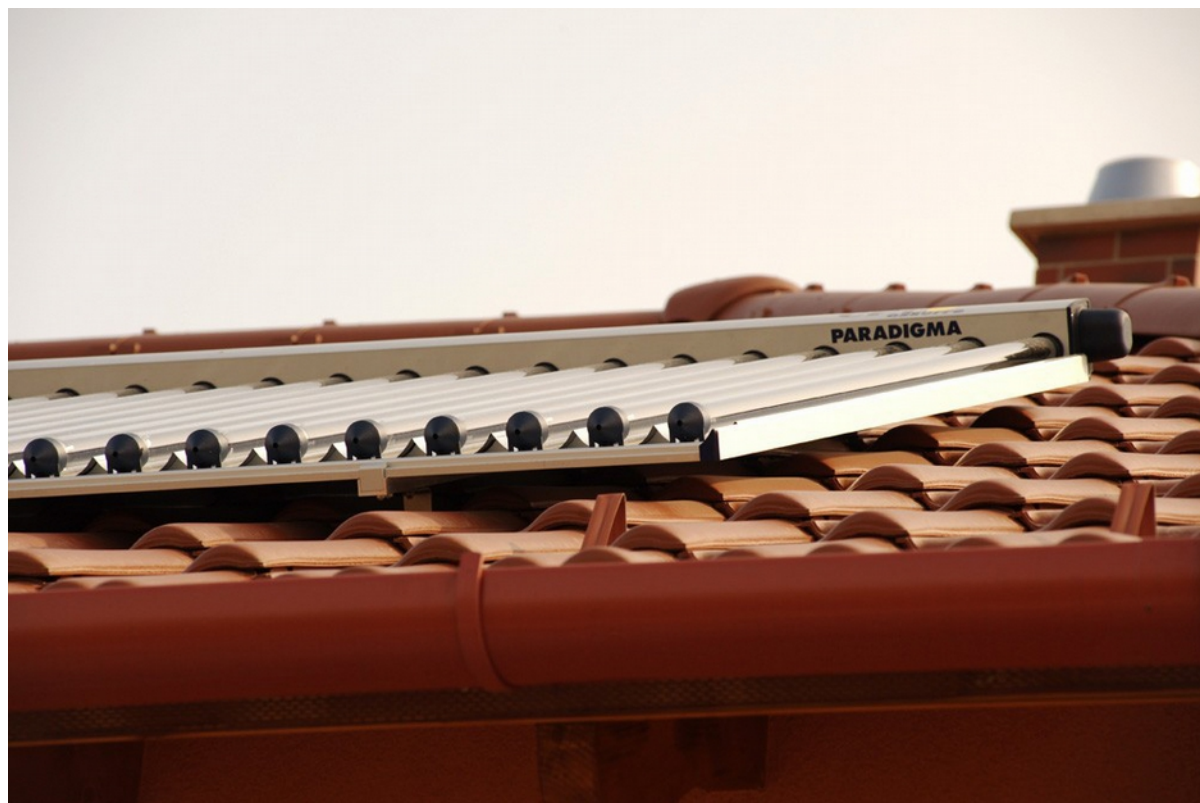
A kollektor elhelyezkedése a tetőn /1.sz. kép/
