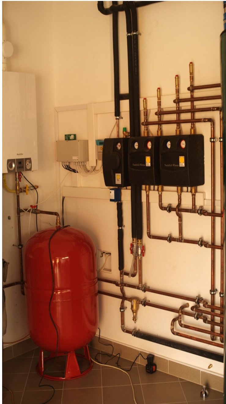
A HSM kevert fűtőköri állomások, solra hidraulika, fűtésvezérlés és solar szabályzó elhelyezkedése /5.sz. kép/
