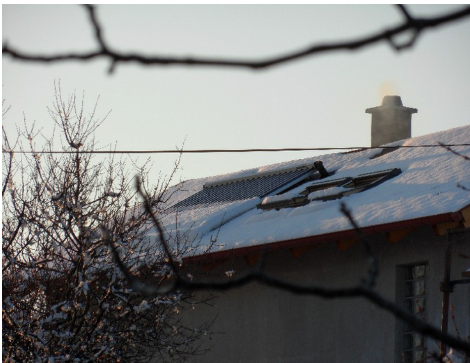
A napkollektor elhelyezkedése a tetőn /1.sz. kép/
