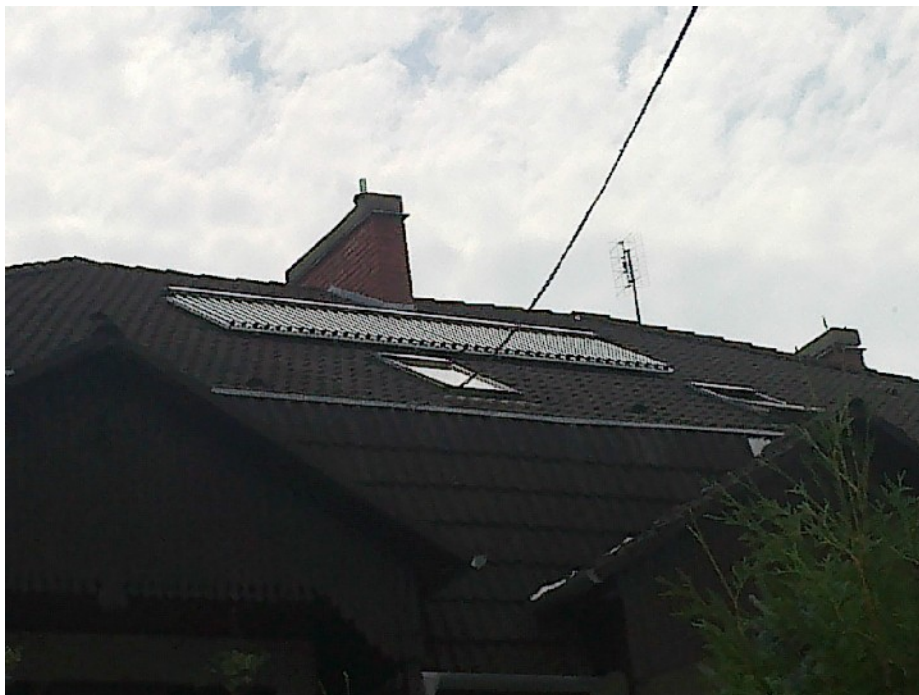
A napkollektor elhelyezkedése a tetőn /1.sz. kép/
