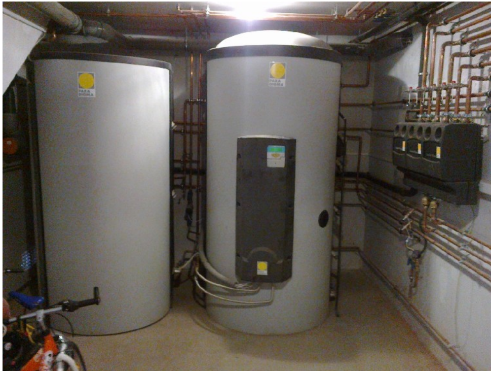
5. sz. kép: Puffer tároló kaszkád
