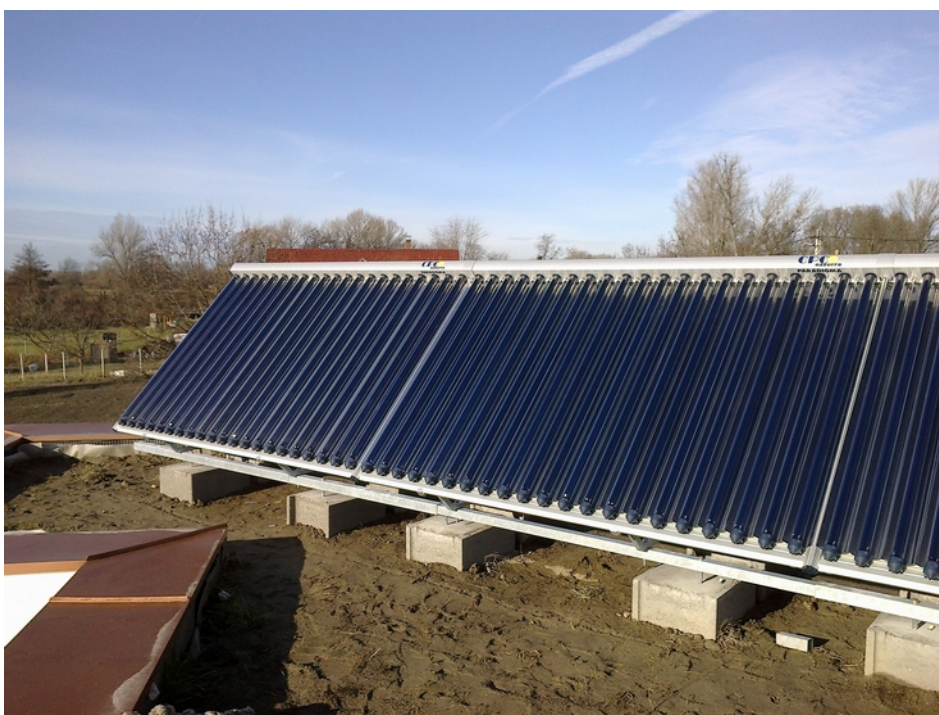
A napkollektor elhelyezkedése a tetőn /1.sz. kép/
