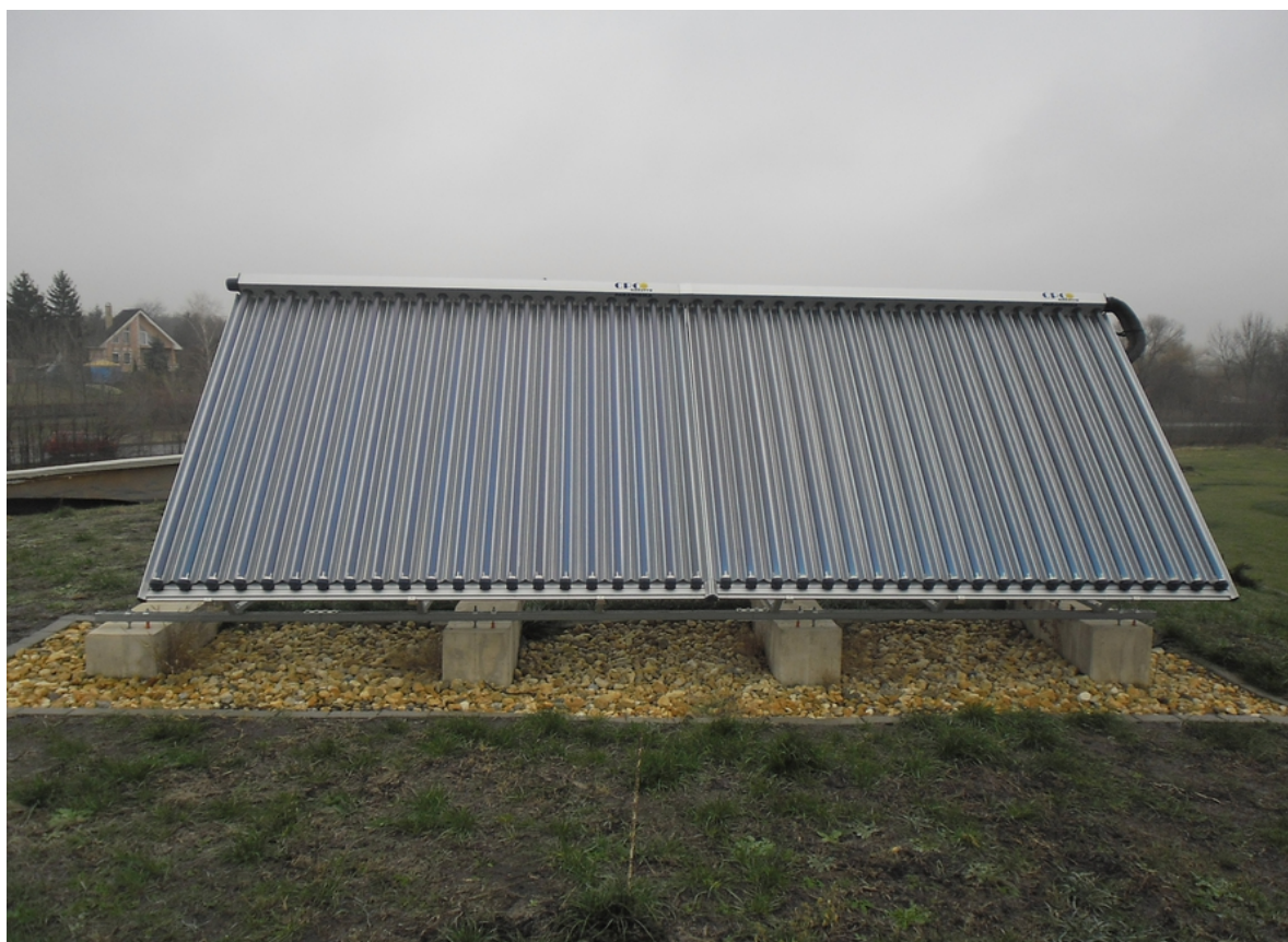
A napkollektor elhelyezkedése a zöldtetőn /1.sz. kép/
